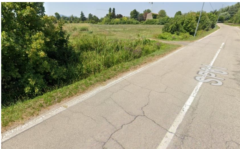
Figura 17 - Lo scolo lungo la via Ponte della Fabbrica.
