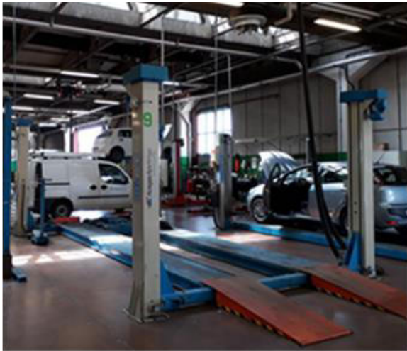
Figura 9. Ponte sollevatoio a 6 assi.
