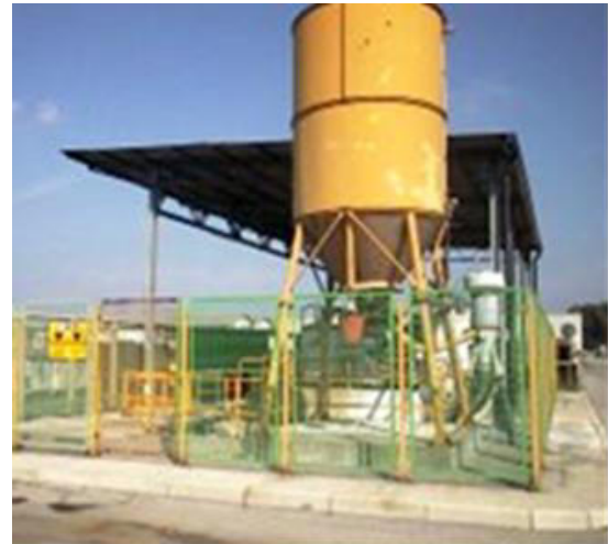
Figura 10. Impianto di depurazione.
