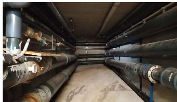
Cunicolo distribuzione piscina esterna
