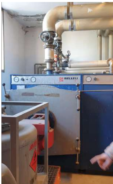
Centrale termica - caldaia
