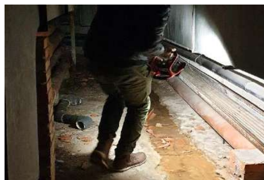
Cunicolo distribuzione piscina esterna
