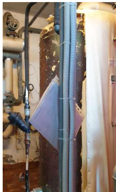
Centrale termica - boiler
