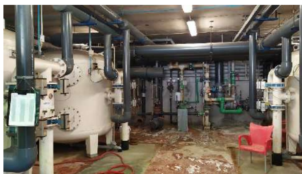
Impianto filtrazione della piscina esterna
