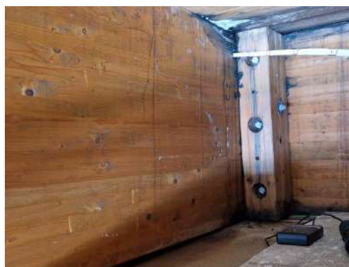
Dettaglio degli effetti delle condense
