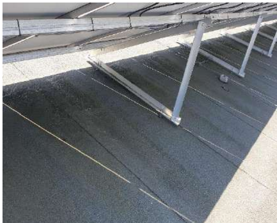
Telai impianto fotovoltaico
