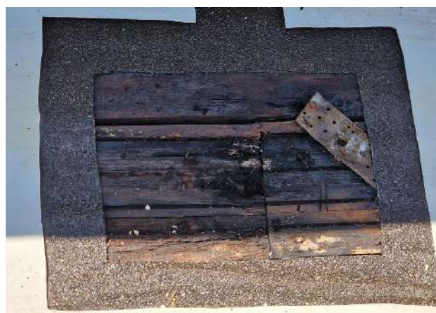
Stato tavolato e degrado delle fasce metalliche di controvento
