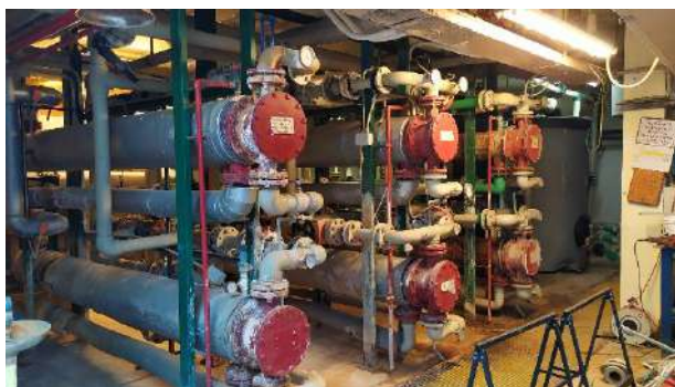
Scambiatori piscina interna
