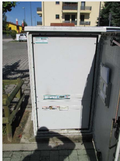
Via Puccini: Riduttore di flusso da ripristinare
