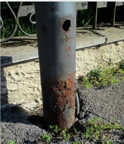
Via S. Paoloi: Pali con corrosione passante
