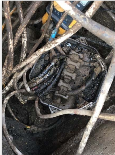
Via Calle Pace: Derivazioni interrata da rifare
