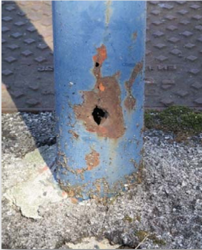
Via Ghislandi: Pali con corrosione passante
