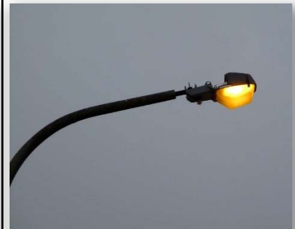
Vicolo delle Terme: Palo in cac e apparecchio danneggiato
