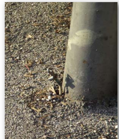
Via Flacco: Collegamento di messa a terra scollegato
