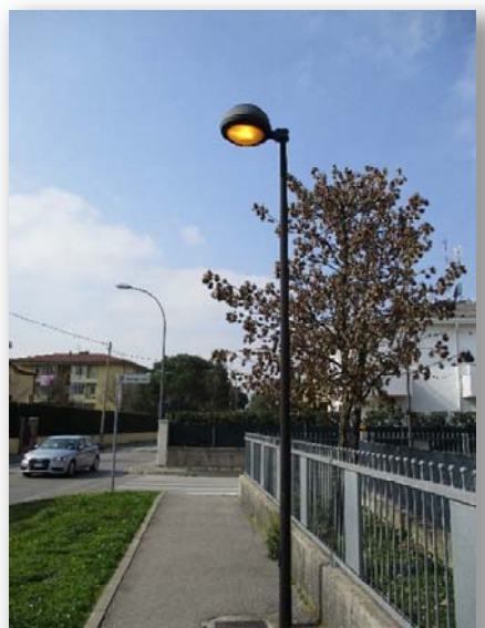
Via Calle Pace punto luce in condizioni sufficienti ma inadatto al sito
