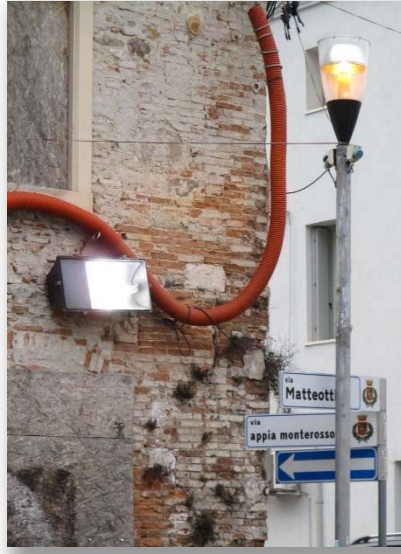
Via Matteotti: Supporto proiettori di tipo precario
