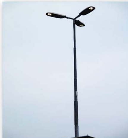
Via 1° Maggio: Modifica non conforme del palo
