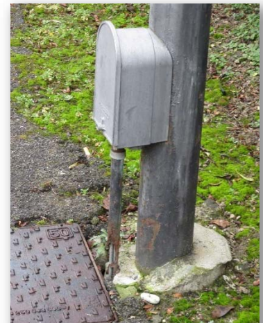
Via Cilea: Derivazioni deteriorate
