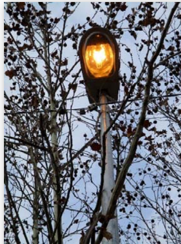
Via Ponte della Fabbrica: Alberatura interferente
